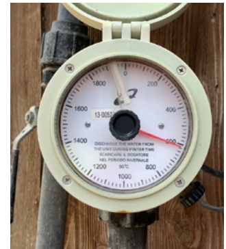
Der Durchflussmesser ermöglicht eine präzise Dosierung der Wasserzufuhr.
